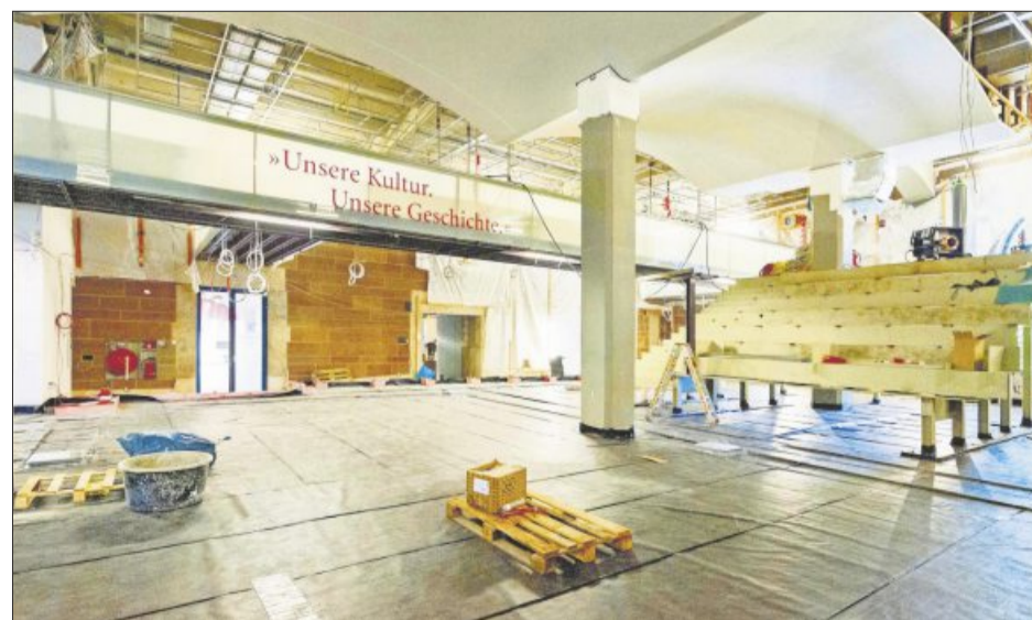
Das Stahlgerüst für die künftige Arenatreppe in der Eingangshalle des Alten Stuttgarter Schlosses nimmt Formen an.
