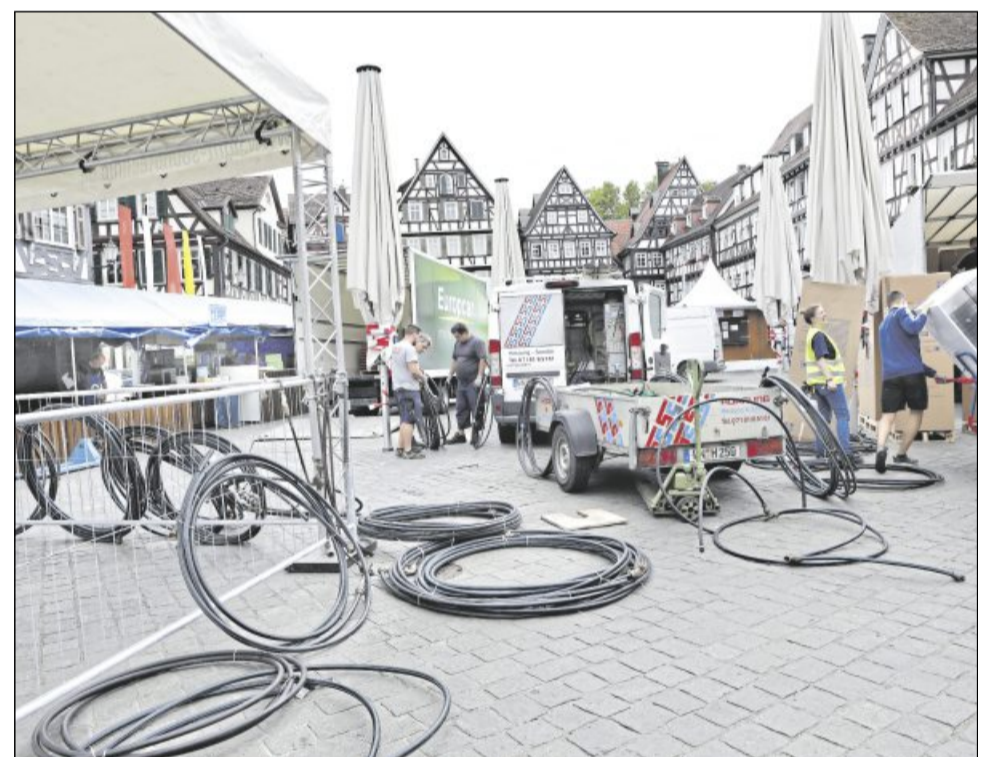
Bis es losgeht, wird jeder Verein seinen Strom- und Wasseranschluss haben.
